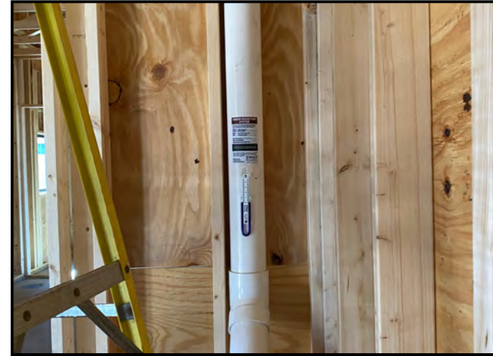
Manometer on riser
