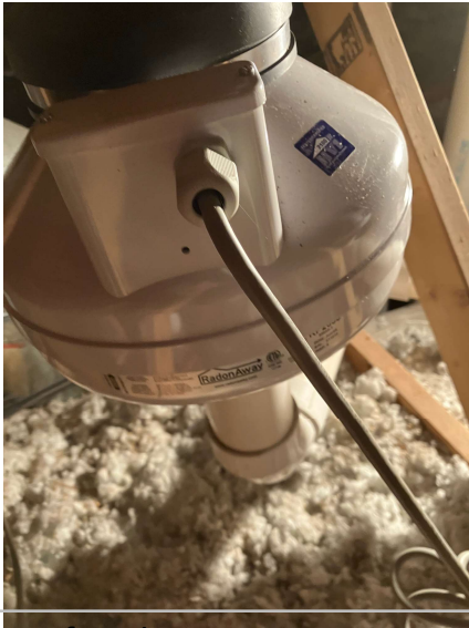
Description: fan close up
