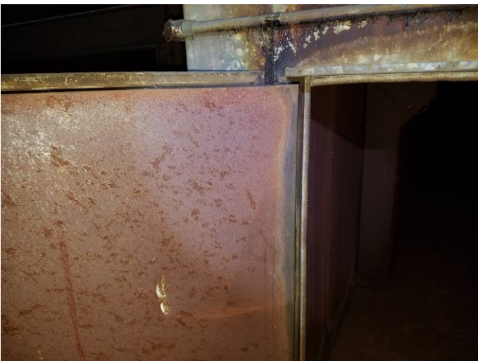
Photo 3) Silver Air Handler Door Gasket – Bldg 8A Mezzanine
